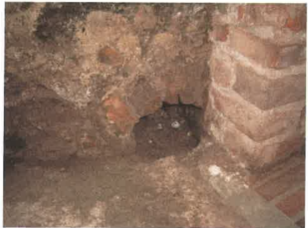
Fot. 4. Kanał odprowadzający wodę z piwnicy i lawetarza
