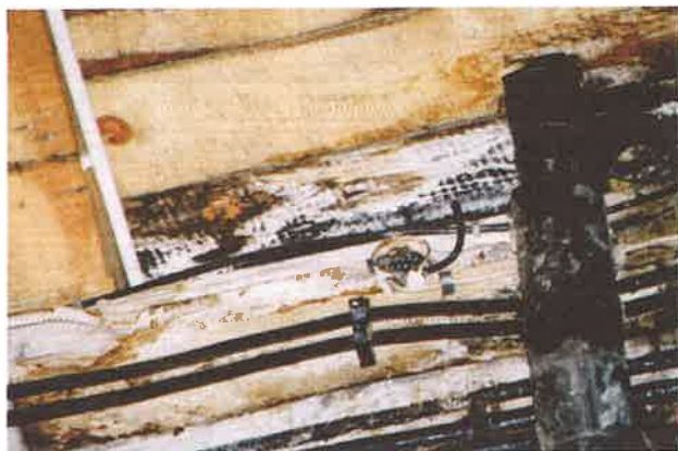
Rys. 5. Rozkład grzybowy zrekonstruowanej połaci dachu na skutek błędów wykonawczo projektowych. Zajeżdźnia tramwajowa w Poznaniu przy ul. Gajowej 1 (Fot. A. Kuberka).
