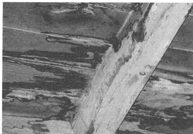
Rys. 3. Wykwity grzybni. Zajeżdźnia tramwajowa w Poznaniu przy ul. Gajowej 1 (Fot. A. Kuberka).
