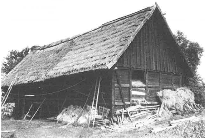
Ryc. 12. Stodoła (XIX w.) konstrukcji ryglowej wypełnionej deskami (tarcicą). Rogalin, gm. Mosina. Fot. A. Pelczyk, 1991 r.
