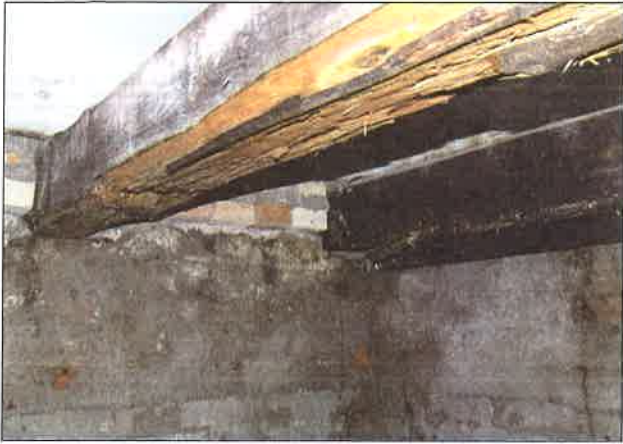
Il. 18. Belki stropowe piwnicy w chałupie z Burdajn porażone przez strocza domowego ( Serpula lacrymans ), fot. M. Poniewski.
