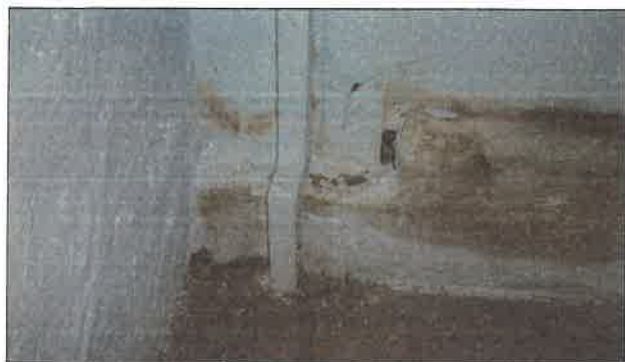
Il. 17. Wnętrze pomieszczenia, widoczne odchody gryzoni i zawilgocenie ściany (Polska), fot. W. Pszczoliński.
