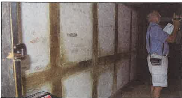
Il. 13. Uboczne skutki impregnacji konstrukcji drewnianej (Dania), fot. A. Pelczyk 2009.
