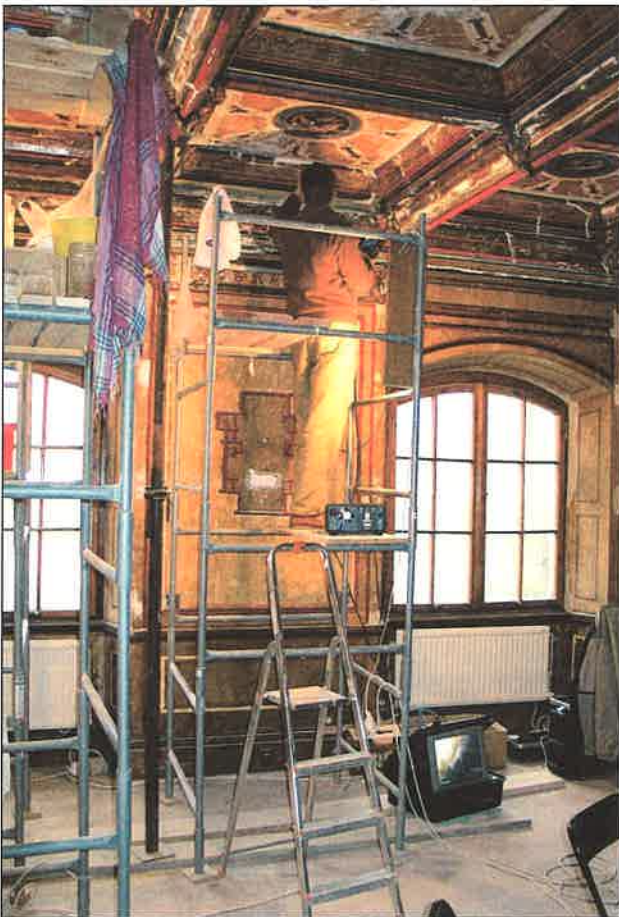
Il. 5. Oględziny przestrzeni wewnątrz stropu w pałacu w Wilanowie – w prawym dolnym rogu fotografii widoczny zarejestrowany obraz na dużym monitorze urządzenia.
