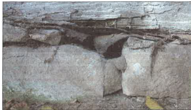
Il. 12. Uszkodzenie izolacji poziomej oraz brak zabezpieczenia otworu dylatacyjnego (Polska), fot. W. Pszczoliński.
