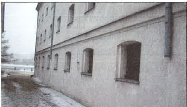
Il. 13. Brak fragmentów rur spustowych (Polska), fot. W. Pszczoliński.
