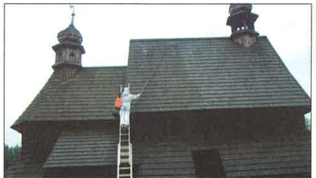
Il. 28. Impregnacja dachu krytego gontem – Górnośląski Park Etnograficzny w Chorzowie – Kościół, fot. W. Pszczoliński.
