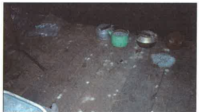
Il. 10. Ślady porażenia podłogi oraz więźby dachowej (Polska), fot. W. Pszczoliński.
