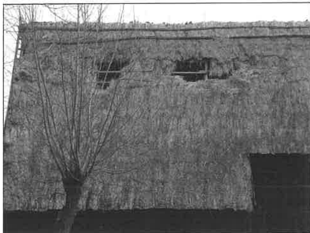
Il. 1. Początek procesu korozji biologicznej wywołany niszcycielską siłą wiatru. Nieszczelność pokrycia dachowego jest główną przyczyną złego stanu technicznego drewnianych konstrukcji, co w efekcie prowadzi do zawilgocenia, zagrzybienia i porażenia przez owady, WPE – Dziekanowice, fot. A. Pelczyk 2006.
