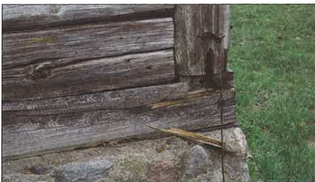
Il. 9. Korozja biologiczna głównych wiązań drewnianej konstrukcji, WPE – Dziekanowice, fot. A. Pelczyk 2011.
