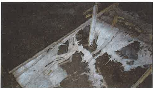
Il. 3. Odkrywka podłogi - widoczna grzybnia grzyba domowego ( Serpula lacrymans ) (Polska), fot. W. Pszczoliński.
