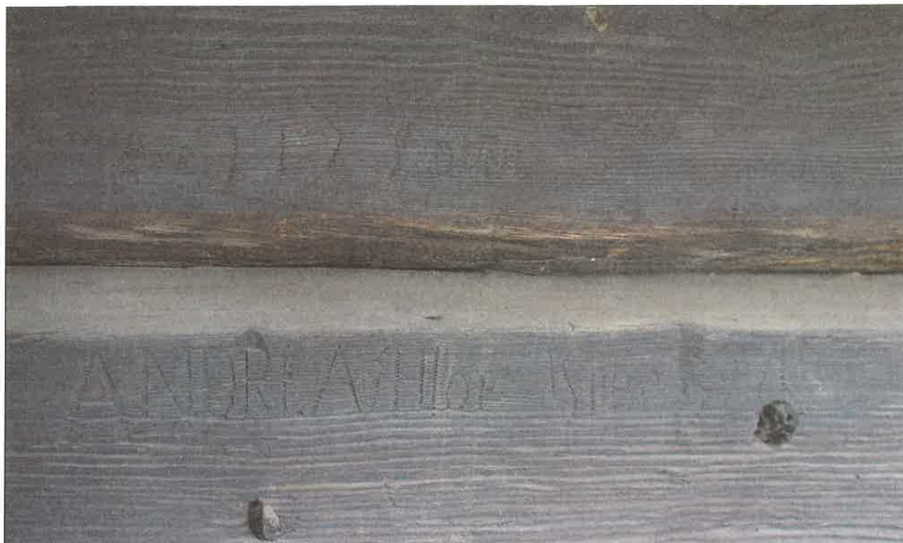
Il. 12. Kościół w Łaziskach. Nawa, ściana pd. Inskrypcja z imionami i datą „1579”. Fot. G. Ruszczyk 2008
