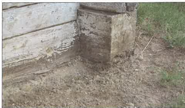
Il. 7. Korozja biologiczna podwaliny złożonej na gruncie (Polska), fot. A. Pelczyk 2011.
