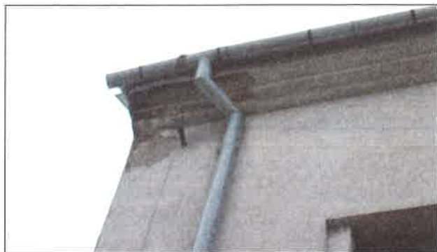
Il. 14. Oberwany fragment gzymsu – następstwo uszkodzonego orynnowania (Polska), fot. W. Pszczoliński.
