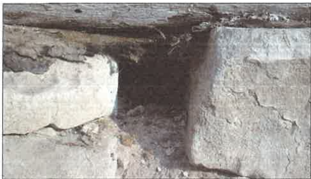
Il. 11. Uszkodzenie izolacji poziomej oraz brak zabezpieczenia otworu dylatacyjnego (Polska), fot. W. Pszczoliński.
