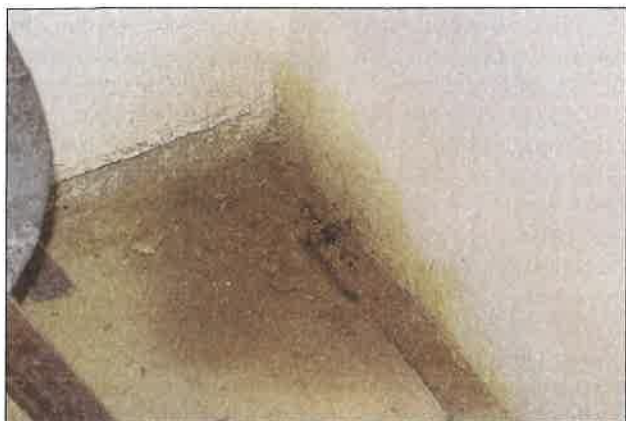
Il. 4. Korozja biologiczna podwaliny spowodowana przeciekającym stropem (Polska), fot. A. Pelczyk 2010.
