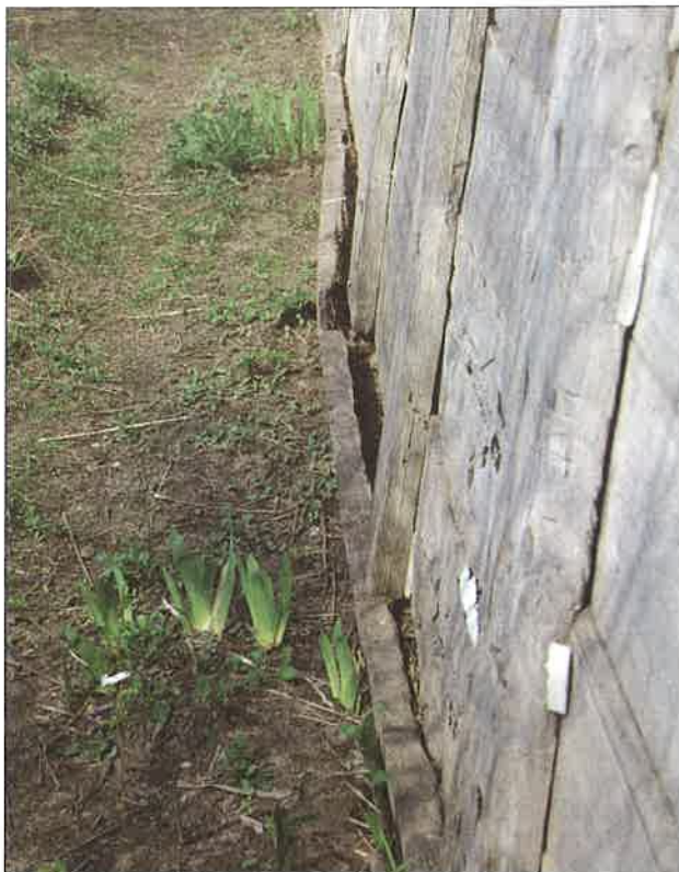
Il. 8. Korozja biologiczna podwaliny złożonej na gruncie, WPE – Dziekanowice, fot. A. Pelczyk 2011.
